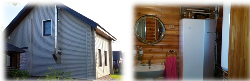
Тепловой насос «воздух-вода» мощностью 3,5 – 12 кВт для отопления и горячего водоснабжения частного дома из бруса в р-не оз. Нарочь.
