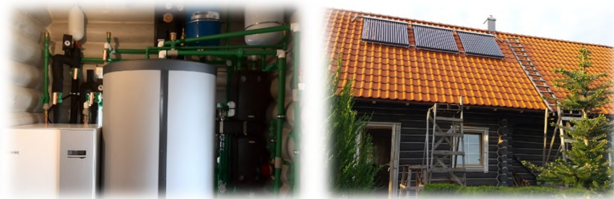
Тепловой насос «грунт-вода» и комплект вакуумных солнечных коллекторов для отопления и горячего водоснабжения частного дома в Логойском р-не.
