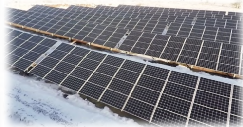
Солнечная электростанция 1.25 МВт Ляховичи, Гродненская область
